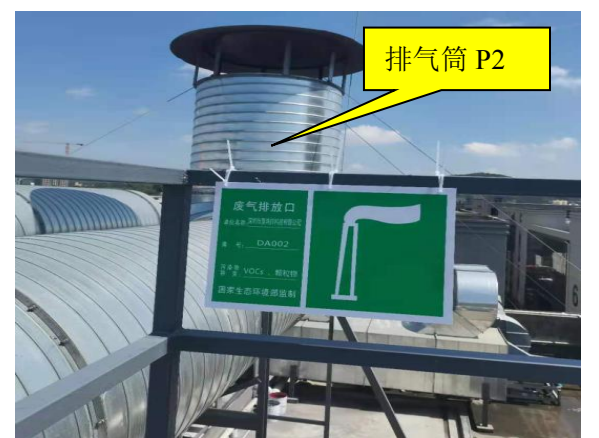
楼顶废气处理设施（排气筒P2）
