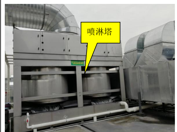
废气处理设施喷淋塔
