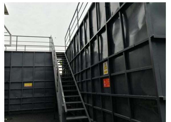
废水收集装置
