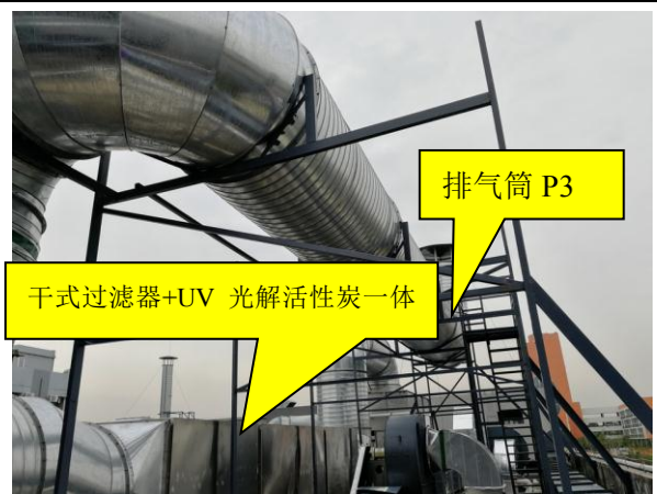
楼顶废气处理设施（排气筒P3）
